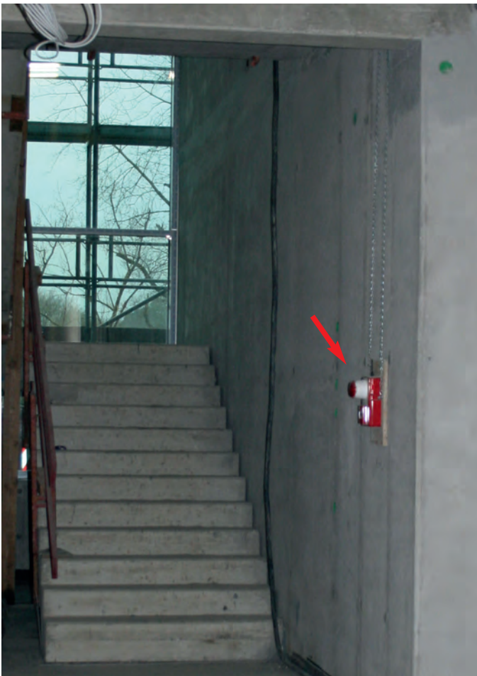
Druckknopfmelder auf einer Baustelle (Foto: BG BAU / Rathmann)
