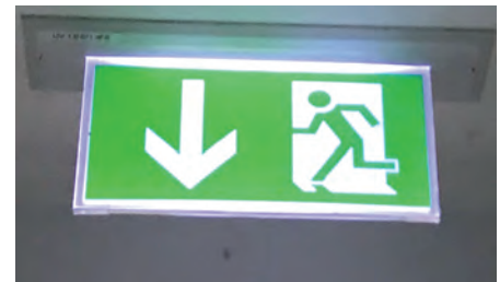
Beleuchtete Beschilderung eines Flucht- und Rettungsweges
